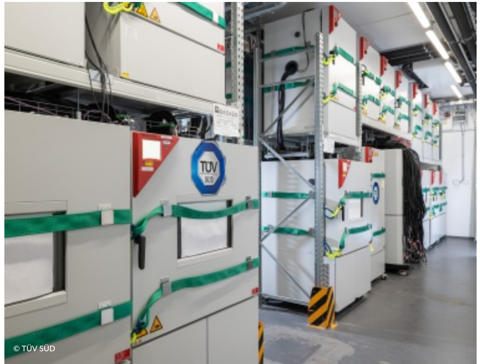
© TÜV SÜD Prüfstände für den Leistungstests von Batteriezellen
